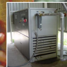
Sistemas de aire acondicionado
